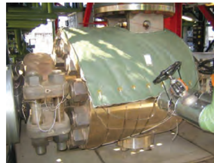
Находящийся в холодном климате Скандинавии, этот крупный шаровой кран с отверстием класса ASME 4500 установлен на выпускном отверстии водородного обогревателя.
