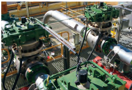
10-дюймовые клапаны 600 класса с гидроэлектрическими приводами установлены в цехе кислотного выщелачивания никеля под высоким давлением.
