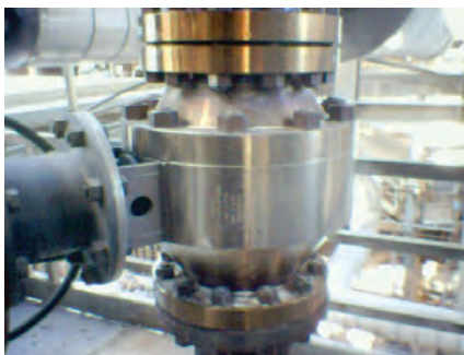
Этот восьмидюймовый кран модели CA-DRI класса ASME 300 справляется с катализатором при температуре 1425°F / 774°C на протяжении многих лет. Это основной изоляционный кран между третьей и четвертой стадией циклонного сепаратора.
