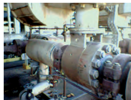
Этот 10-дюймовый кран для катализатора с заземленными неподвижными опорами на концах модели CA-HO1 класса ASME 2500, установленный в 1995 году, все еще находится в эксплуатации на крупном итальянском нефтеперерабатывающем заводе.
